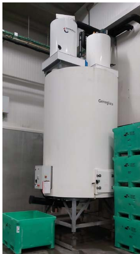
Silo en scherfijsmachine.
