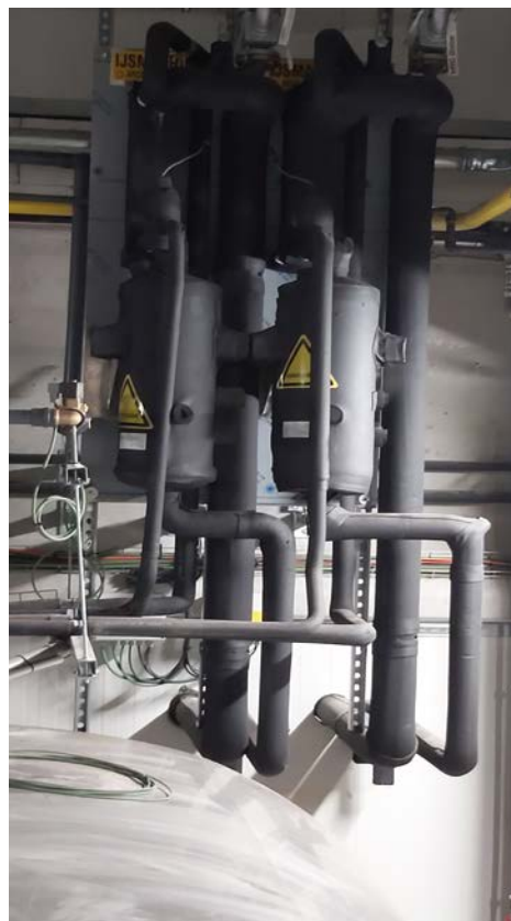
L'échangeur à plaques CO 2 NH 3 + réservoir de liquide NH 3 .
