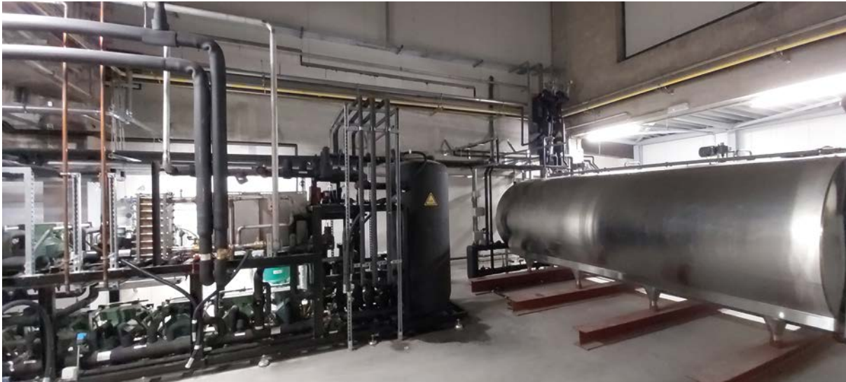
La centrale CO 3 de la criée. L'installation frigorifique et les machines à glace écaïlle ont été entièrement renouvelées avec des réfrigérants naturels CO 2 (R744) et NH 3 (R717)
