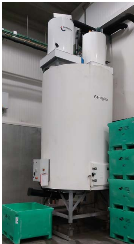
Silo et machines à glace écaïlle.
